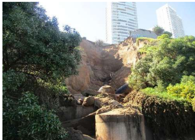
Edificio Kandinsky - Socavón 1
